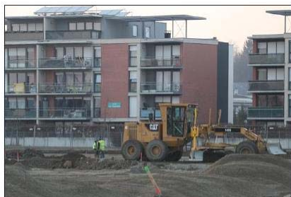
Vue du chantier du nouvel Esat des Papillons blancs au domaine de la Cotonnade à Pfstatt. Photo L'Alsace/Darek Szuster
