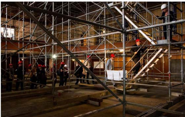
Une forêt d'échafaudages est en place dans la grande salle pour supporter les travaux de la voûte qui devraient s'achever en juin. PHOTOS DNA - MAKSVM TOUSSAINT
