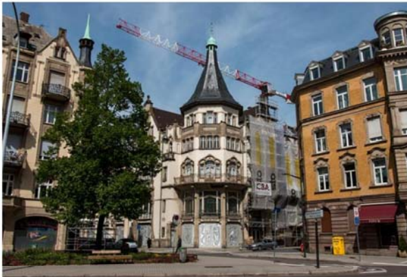
La seconde phase du chantier du palais des fêtes s'achèvera à la fin de l'année. PHOTOS DNA - MAKSVM TOUSSAINT
